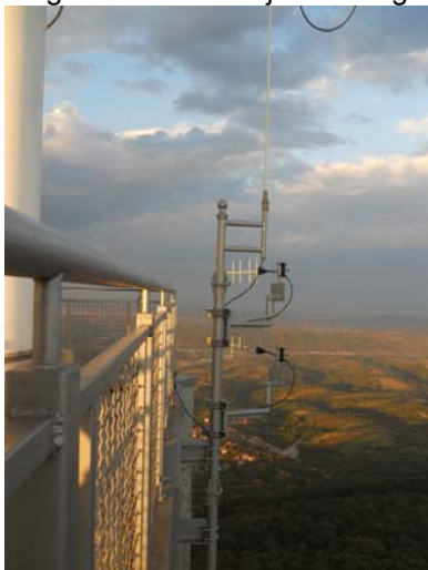
a) Instalacija nosača antena
